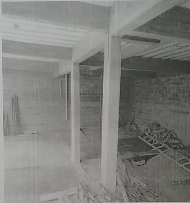
Foto 02 – Garagem sem escoramento
